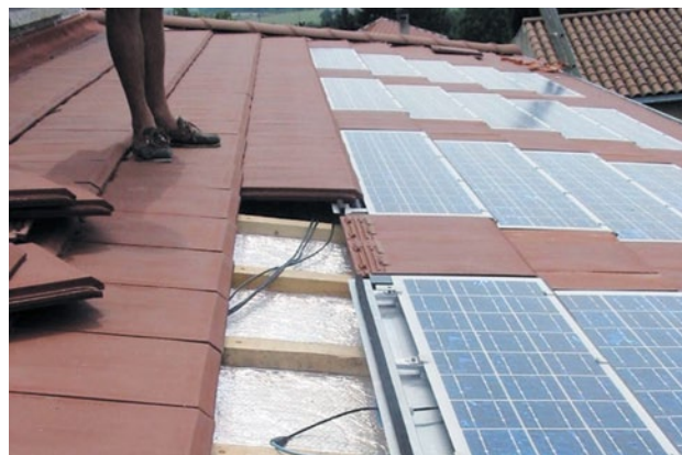
Intégration en toiture de tuiles photovoltaïques.
